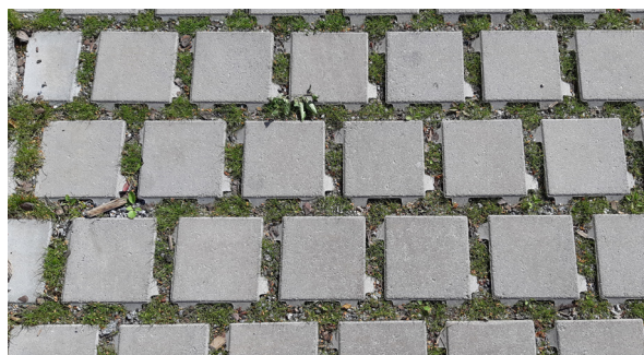
Genomsläpplig beläggning på bilparkering.
